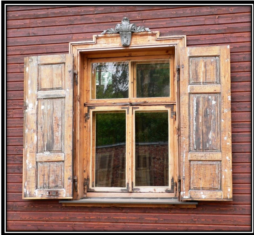
Krāsotāju ielas Nr.12, Puškina ielās Nr.4 nama iebūvēta logu aile ar slēģiem un cinka sakausējuma dekoru. 2014.gads.
